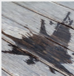
Nedvességfoltok a kezeletlen fafelületen
